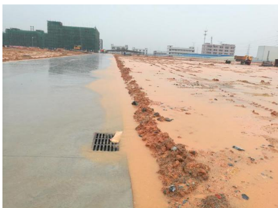
厂区临时土质排水沟
